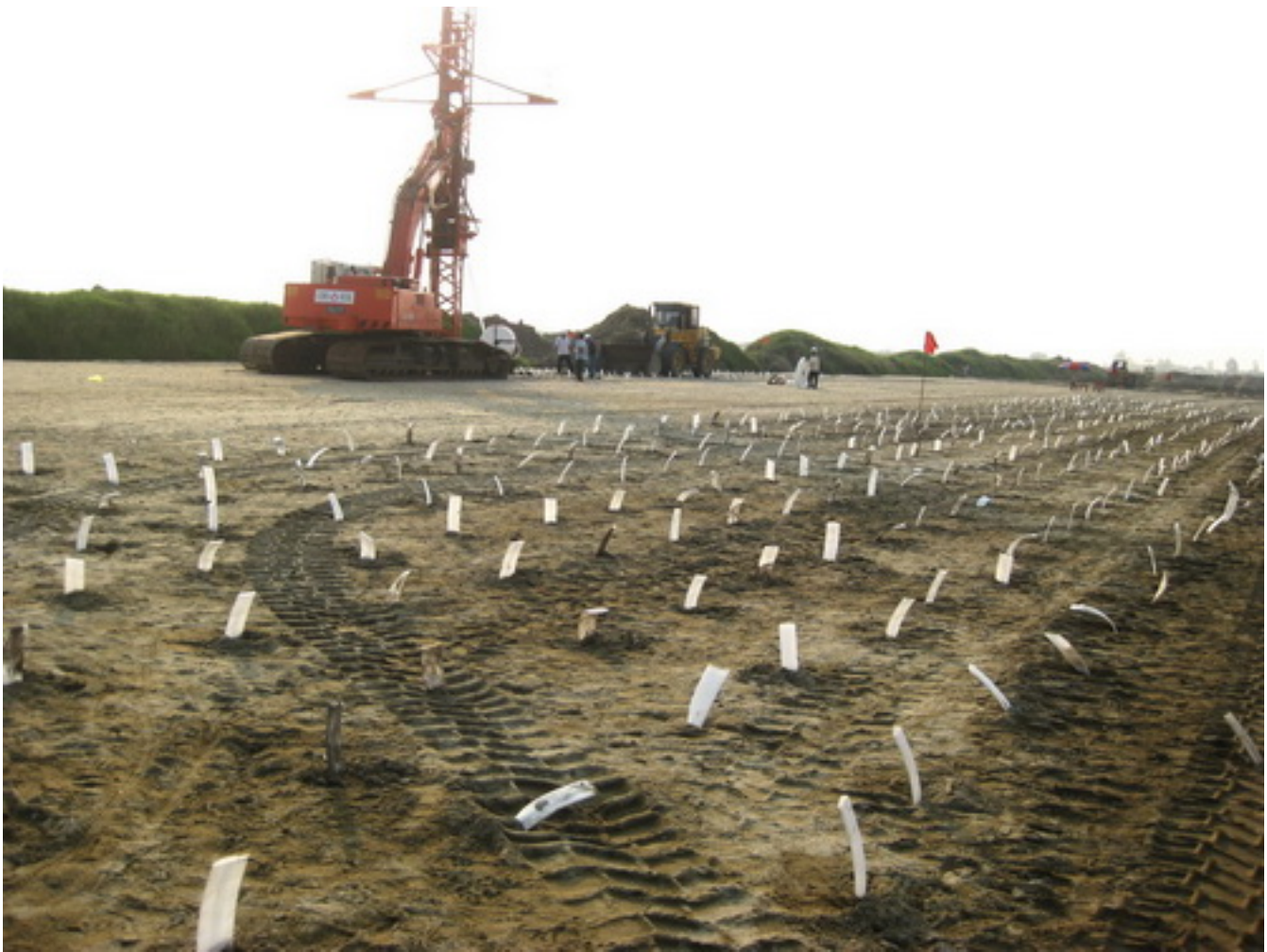
Hình trình bày thi công gói thầu EX7 - dự án đường ô tô cao tốc HN-HP
