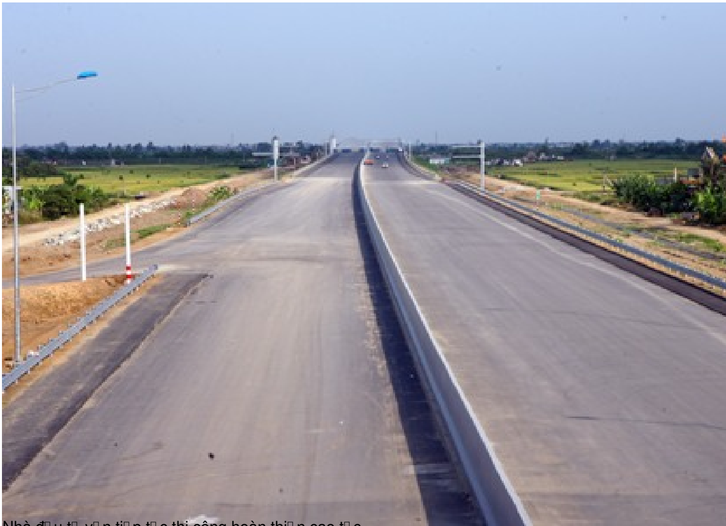
Nhà đầu tư vốn tiếp tục thi công hoàn thiện cao tốc
