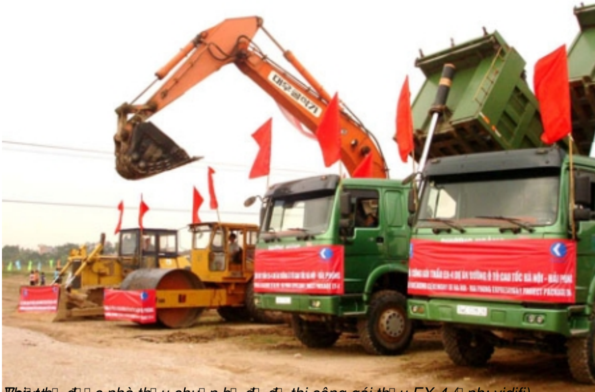
Vantb đã c nhà thầu chu n b đã đ thi công gói thầu EX-4 (nh: vidifi)
