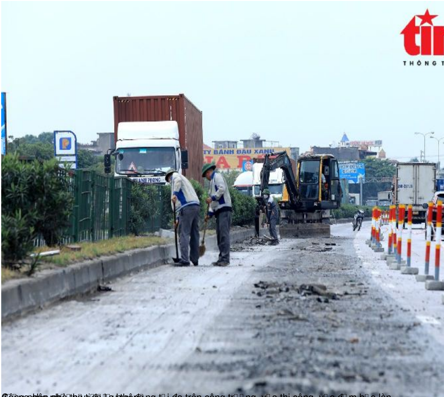
Công nhân phá dỡ vỉa hè cũ để thi công vỉa hè mới trên công trường, vỉa hè thi công, vỉa hè đã mìn bỏ làn
